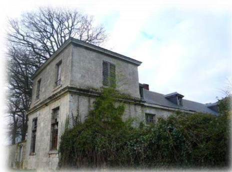
Maison en état de délabrement à Vers-lès-Chartres (Even Conseil)
