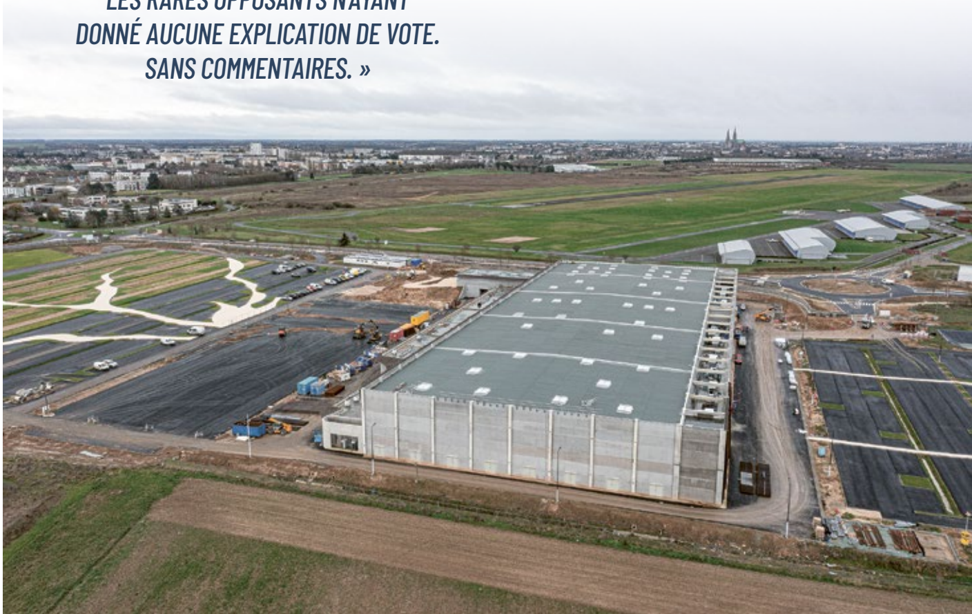
Le nouveau parc des expositions de Chartres métropole entrera en service dans quelques semaines.
